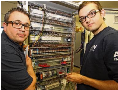
Feinarbeit: Schaltschränke werden nach Maß für ihren jeweiligen Einsatzzweck gebaut.
