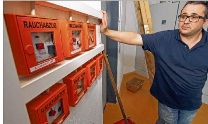
Dennis Woyciechowski in der Steuerzentrale einer Brand- und Rauchmeldeanlage: Direktleitungen gehen zur Feuerwehr.
