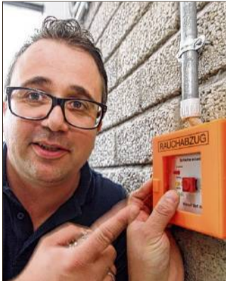
Brand- und Rauchmelde-Technik ist ein wichtiger Bereich.
